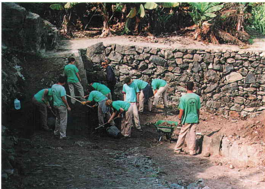
Trabajos de recuperación del antiguo Camino Real de Arucas por alumnos de la Escuela Taller.
